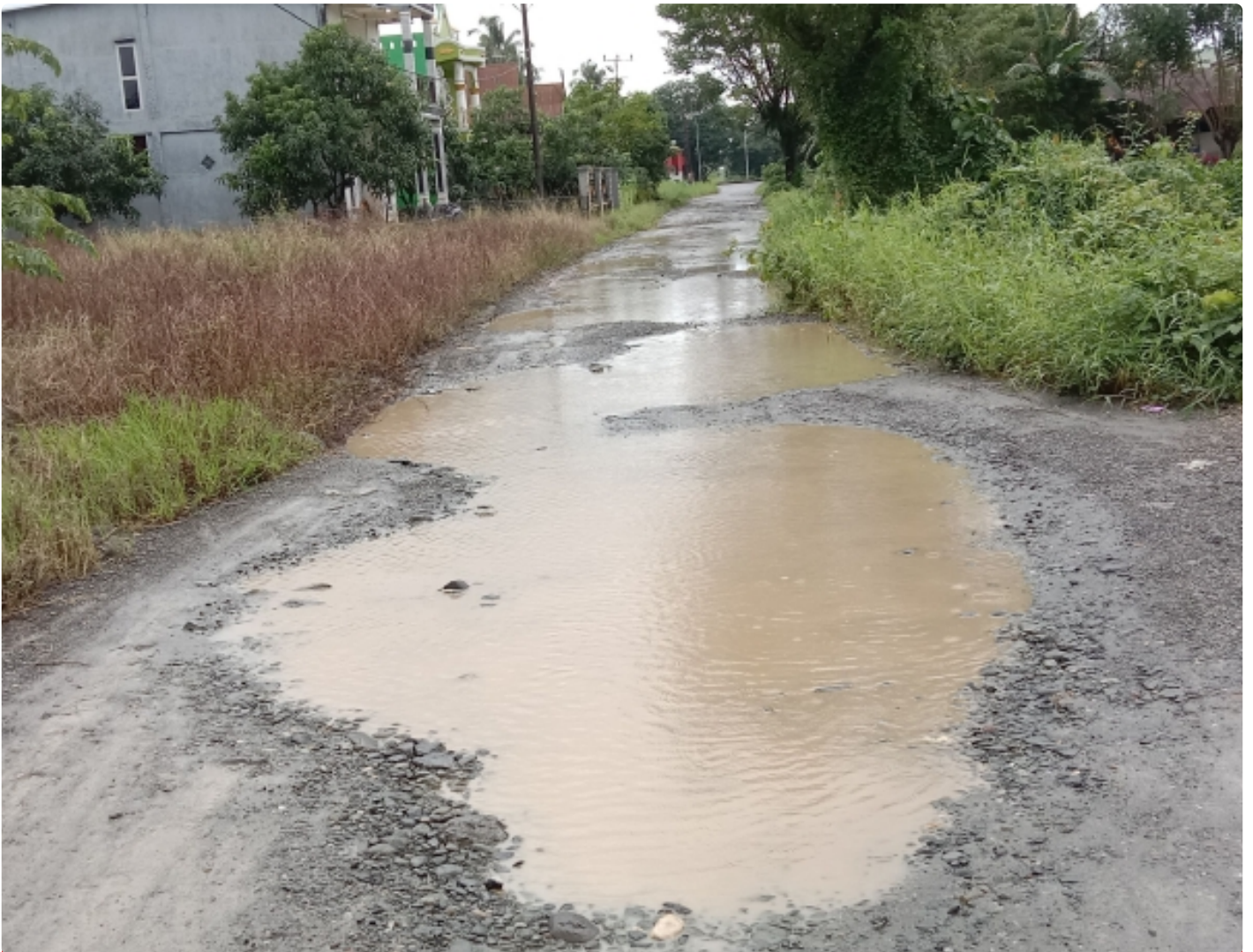
Jalan poros desa Benteng rusak parah
